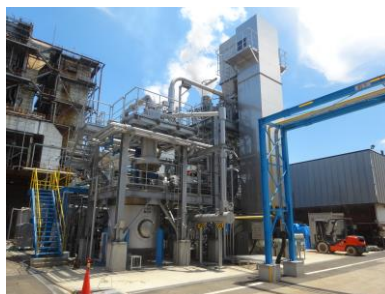
パイロットプラント 三友グループ川崎地区に設置 (水蒸気爆砕・酵素糖化・発酵施設)
