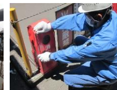
消火設備の確認
