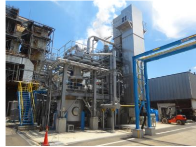
パイロットプラント 三友グループ川崎地区に設置 (水蒸気爆砕、酵素糖化・発酵施設、ATJ施設)
