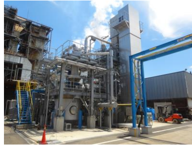
パイロットプラント 三友グループ川崎地区に設置 (水蒸気爆砕・酵素糖化・発酵施設)
