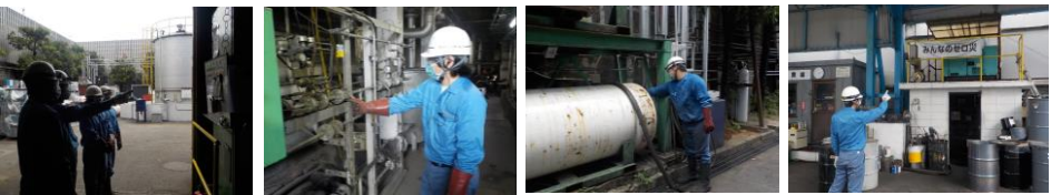
緊急事態訓練一部の様子 (左から：手順書確認、燃料ラインの閉止、アンモニアガスボンベの元栓閉止、非常用発電機の運転確認)
