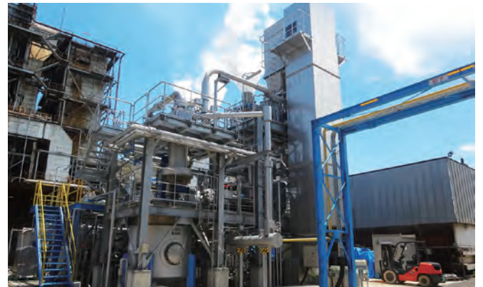
パイロットプラント 三友グループ川崎地区に設置 (水蒸気爆砕・酵素糖化・発酵施設)
